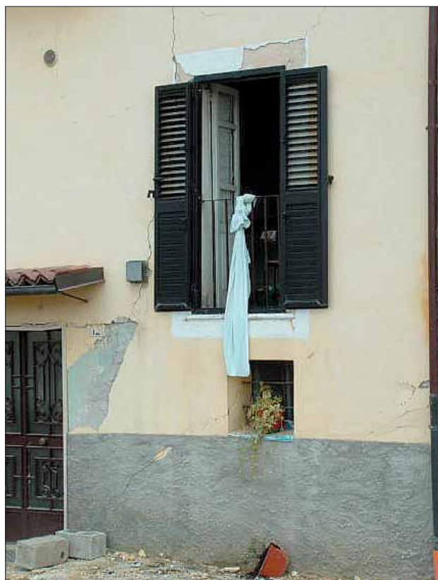
Da questa finestra, calandosi con un lenzuolo, chi vi abitava ha trovato la via di fuga.
